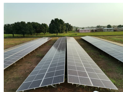
Ländliche Elektrifizierung in Mali
