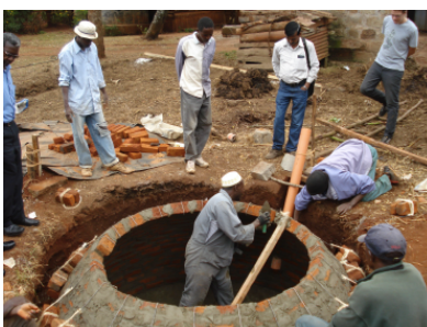
Biogas aus Kuhdung in Kenia
